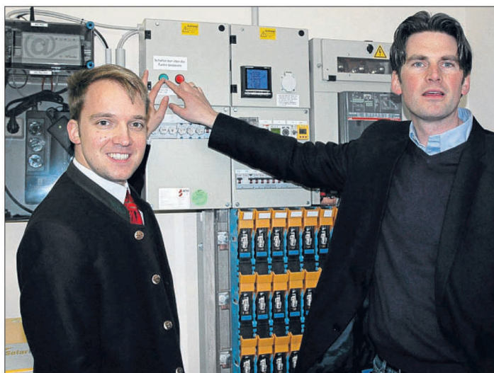
Symbolischer Knopfdruck: Der FDP-Landtagsabgeordnete Tobias Thalhammer (links) und Christian Hierl von der Firma Jura-Holzbau nahmen die Photovoltaik-Anlage offiziell in Betrieb.
